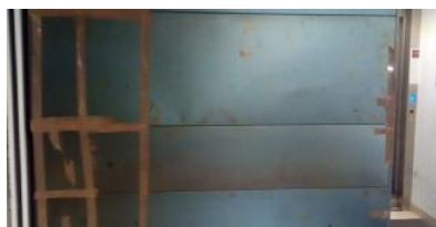
La parete con i pannelli riparati con il nastro adesivo
