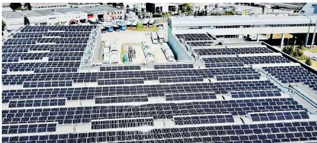
L'impianto. Montati e attivati 2.760 moduli da 400 Watt ciascuno // FOTO STRADA NEG
