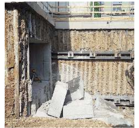
Il muro. I blocchi di cemento abbattuti
